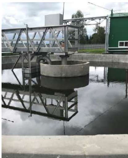
Рисунок 9. Очистные сооружения «Птичное»
