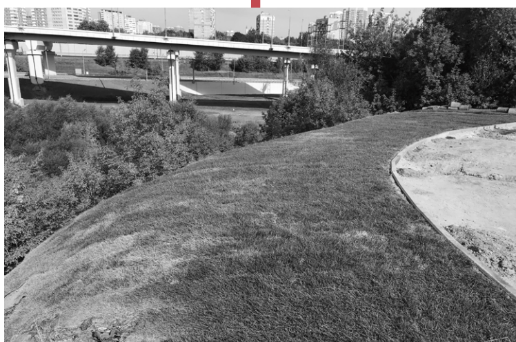
Рисунок 22. Верхняя часть склона в августе 2020 года на месте активизации оползня вблизи школы по адресу ул. Мосфильмовская, д.88, к. 5 (участок Раменка-5)
