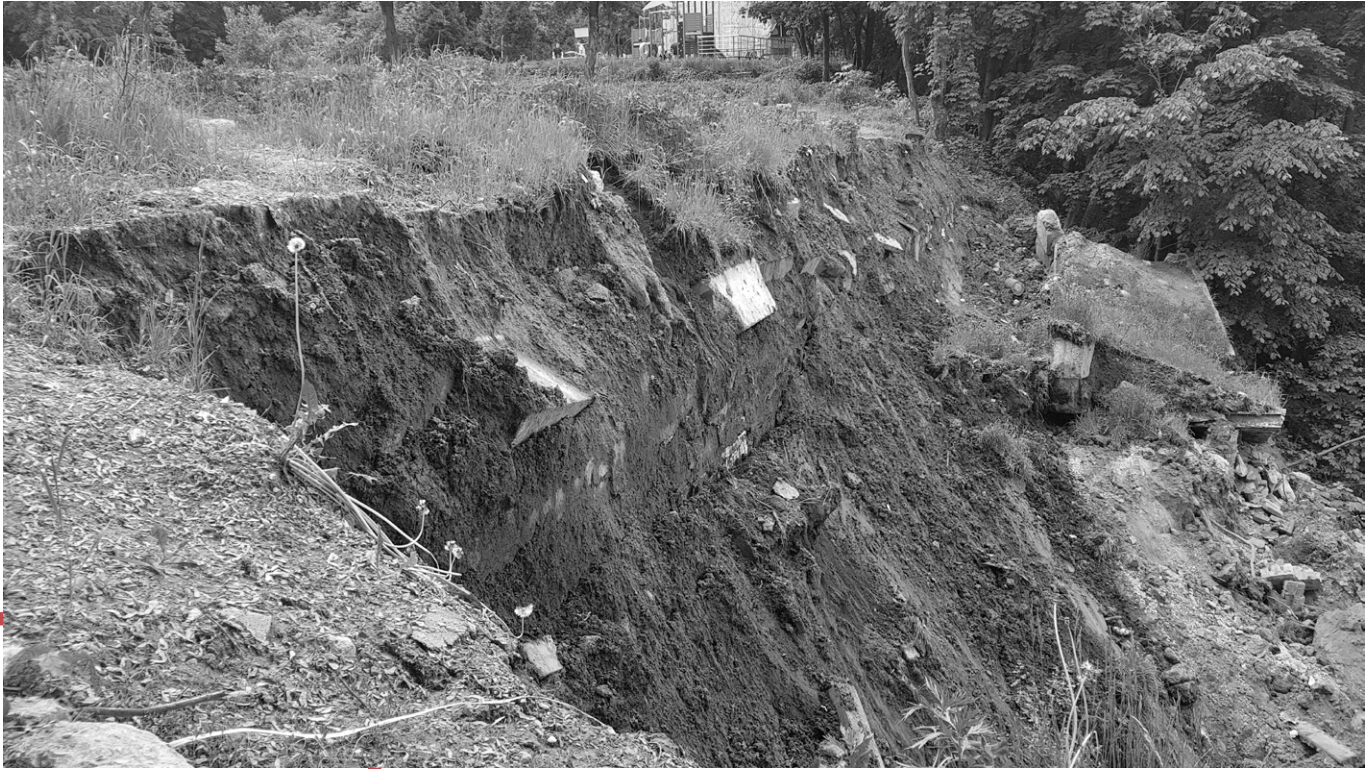
Рисунок 12. Последствия активизации оползневого процесса на территории Филёвского парка (июнь 2020 года)
